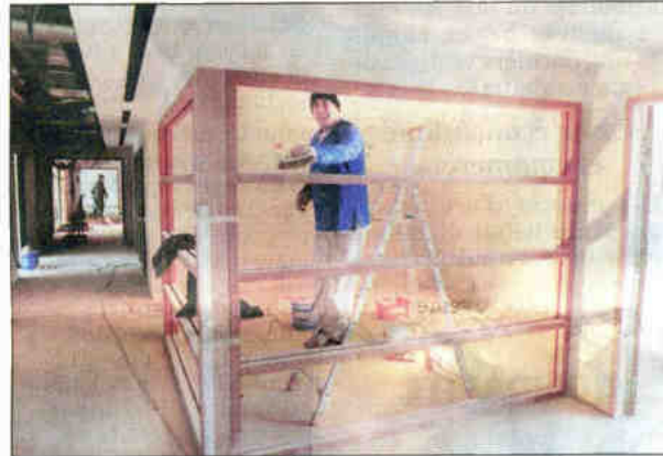
Les différents corps de métier sont dans les temps. Et même mieux que prévu.
